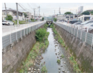
溢水防止板（赤堀排水）
